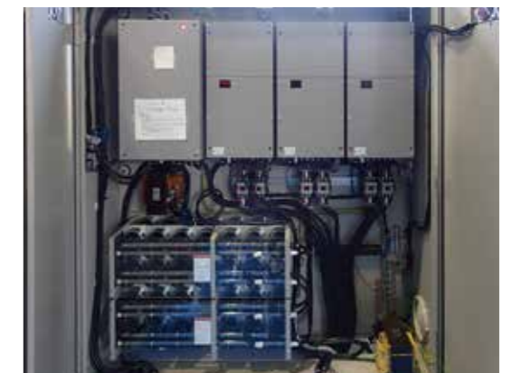
サーボ制御盤 (サーボアンプ・コンデンサ他)
