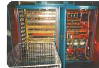
旧型リレーシーケンサ制御盤
